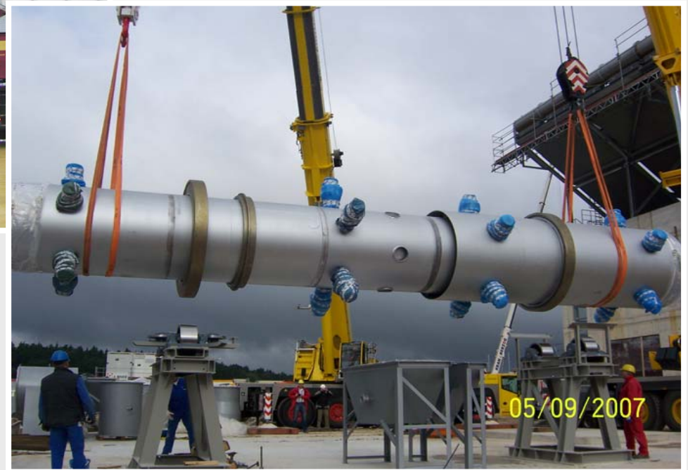
Montage vor Ort
