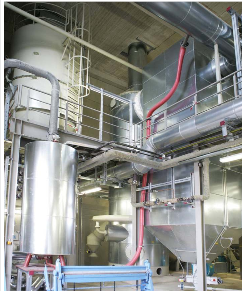
Nachbrennkammer und Wärmerückgewinnung
