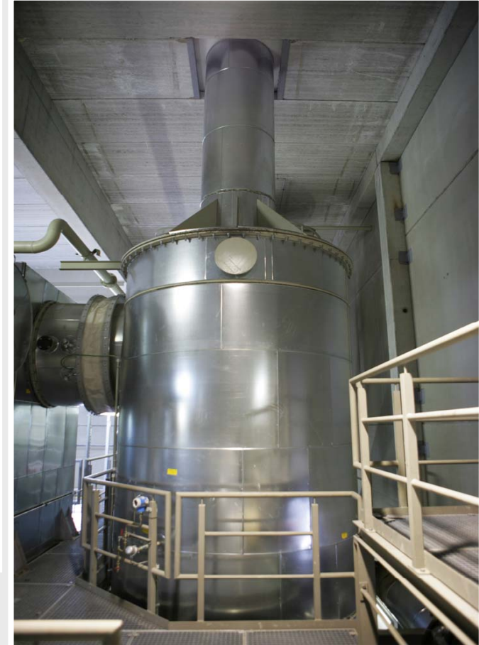
Nachbrennkammer mit Übergang zur Abwärmennutzung und Notkamin
